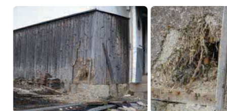
ハチの巣を狙って壊された建物
